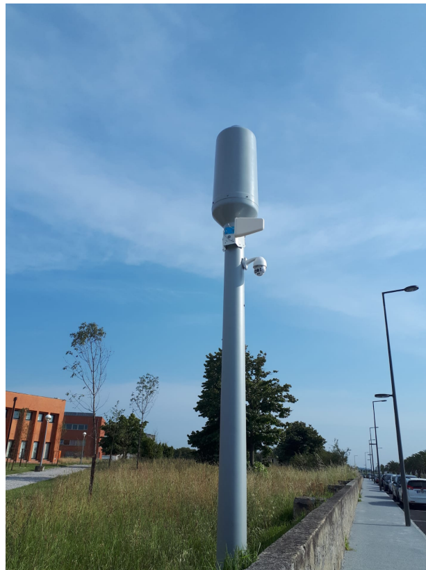
Figure 1: Smart Lamp Post in Instituto de Telecomunicações
